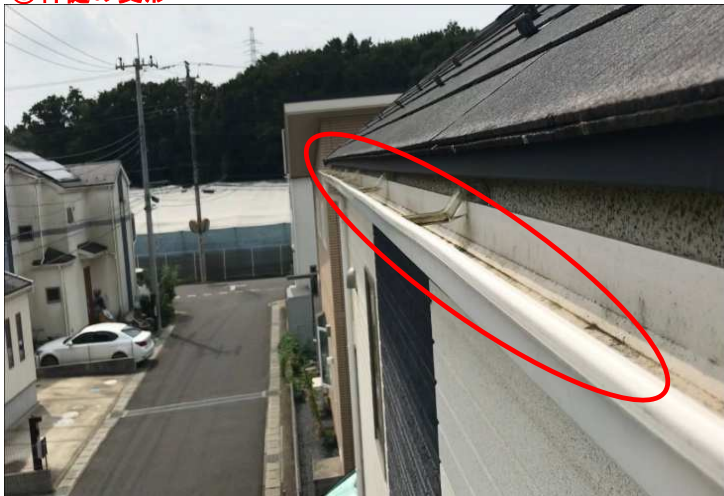
①軒樋の変形
