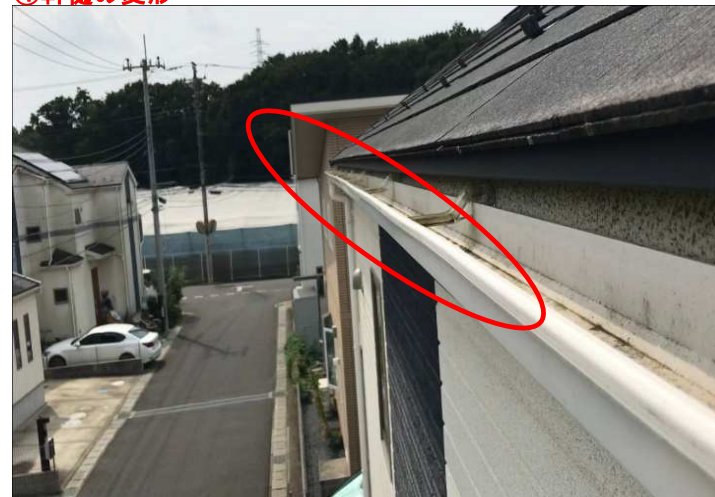
④軒樋の変形
