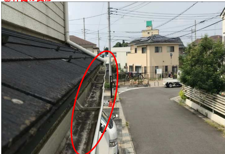
③軒樋の変形
