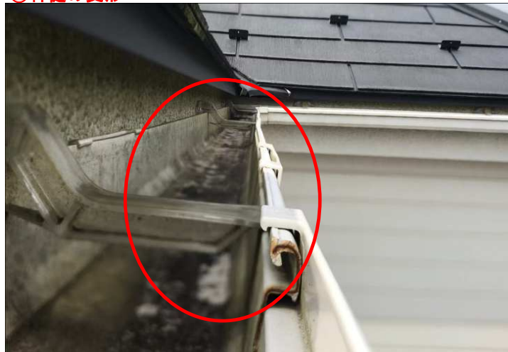
②軒樋の変形
